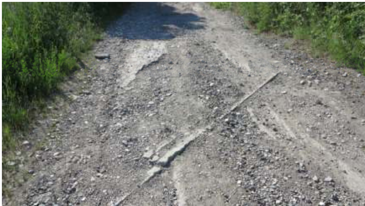
Obr. č.7 Staré zvodnice na lesnej odvoznej ceste nie sú dostatočne udržiavané, aby prerušili odtok .
