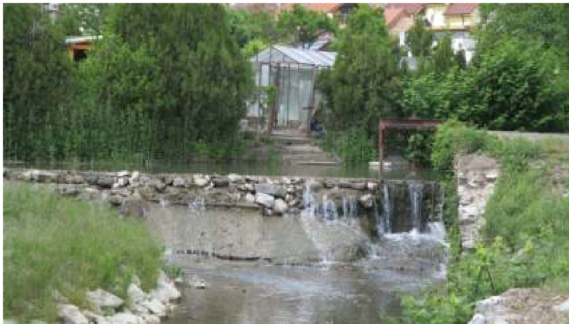
Obr.č.4. Poškodená hať na toku Parná v Horných Orešanoch
